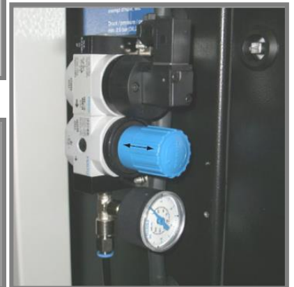
图 5.7 供应装置的压力设置
